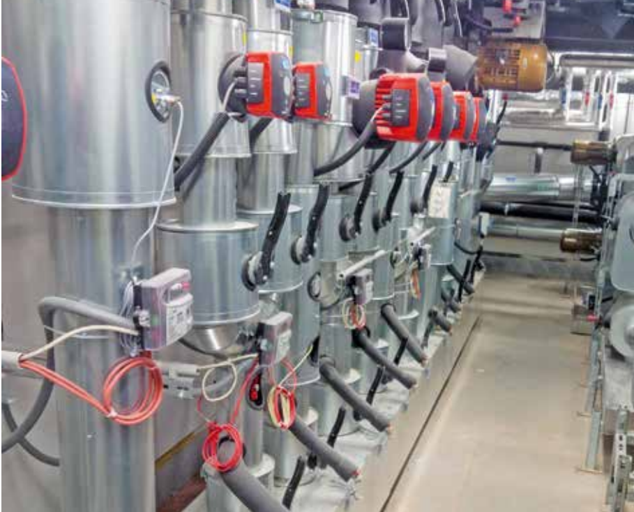
Mit einem durch die Gebäudeautomation gesteuerten Anlagenmix aus statischen Heizflächen, Lüftung und Kühldecken sind alle Büro und Aufenthaltsräume separat regelbar.
