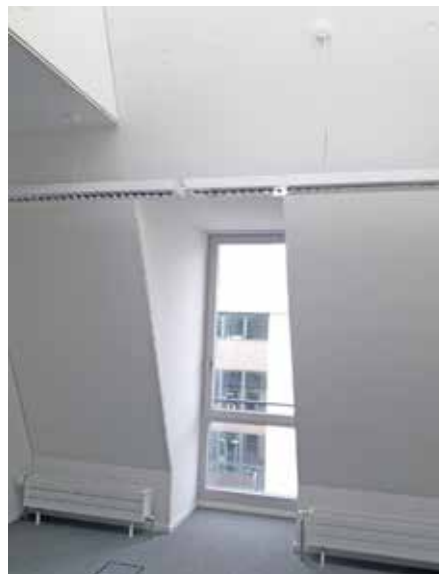
Der gesamte Dachschrägenbereich vom Drempe bis zum Anschluss des Oberlichtes wurde mit aktiven Kühldecken ausgestattet.
