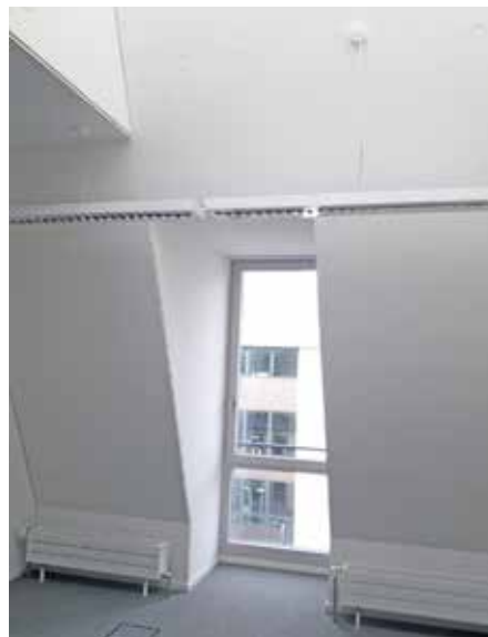
Der gesamte Dachschrägenbereich vom Drempe bis zum Anschluss des Oberlichtes wurde mit aktiven Kühldecken ausgestattet.
