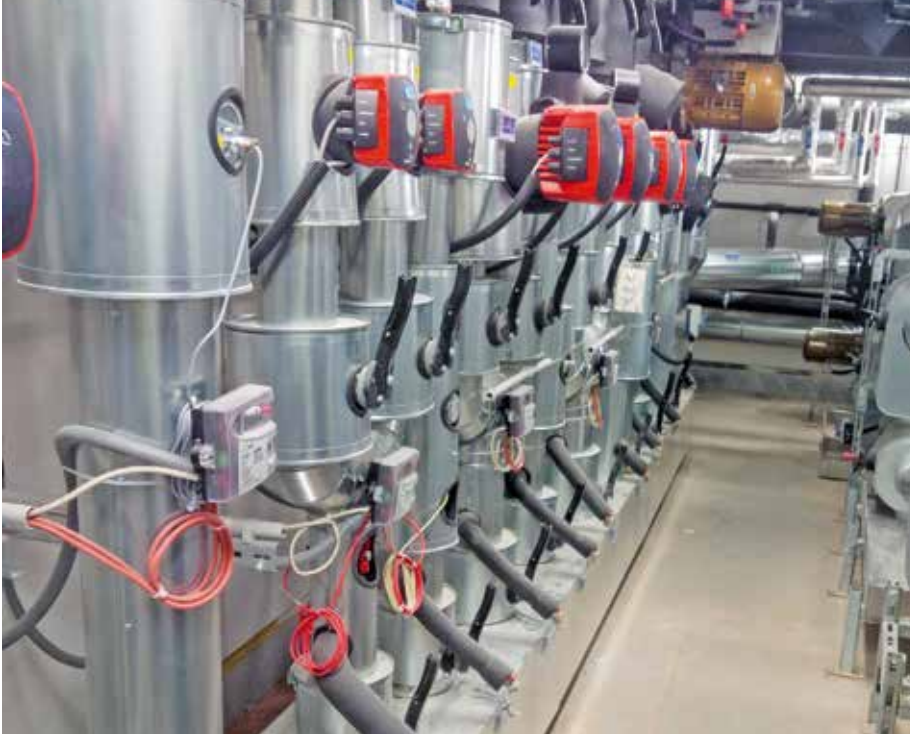
Mit einem durch die Gebäudeautomation gesteuerten Anlagenmix aus statischen Heizflächen, Lüftung und Kühldecken sind alle Büro und Aufenthaltsräume separat regelbar.
